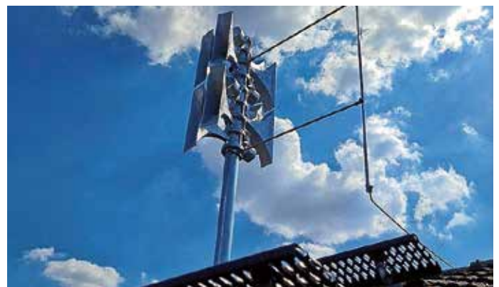
Blick auf die neu installierte Sirene auf dem Rathaus-Dach
