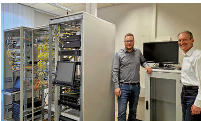
Amtsleiter Andreas Willemsen und Bürgermeister Dr. Ralf Göck im übersichtlich neugestalteten Serverraum Foto: Verwaltung
