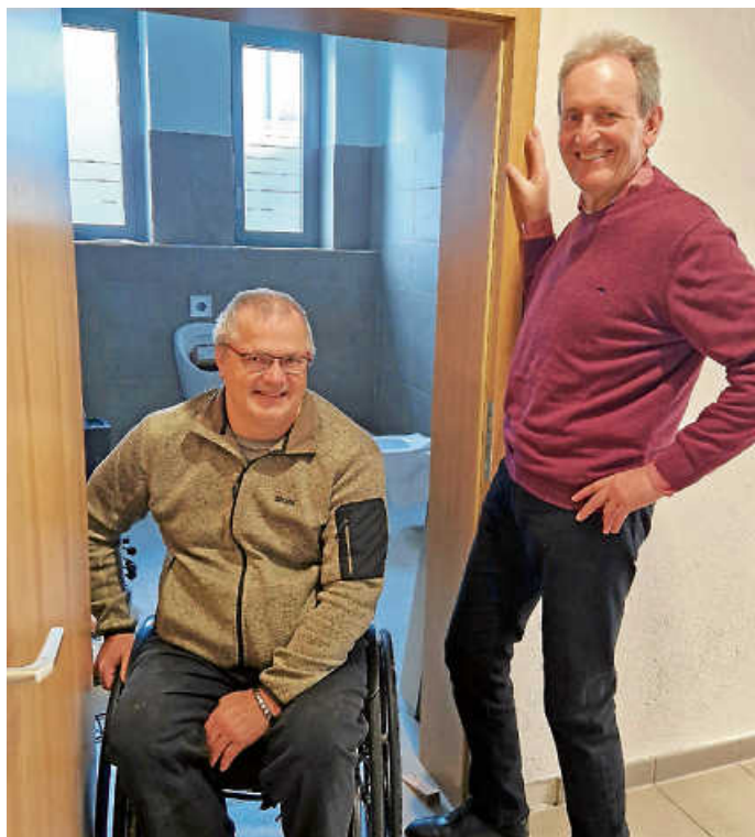
Behindertenbeauftragter Rudi Bamberger und Bürgermeister Dr. Ralf Göck auf der Baustelle im Rathaus Foto: Verwaltung
