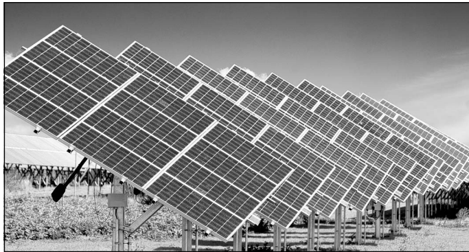
Die Pädagogische Hochschule in Heidelberg wird, dank Fotovoltaikanlagen, nun mit Solarenergie betrieben Foto: Archiv
