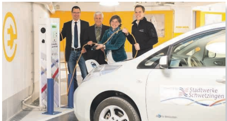
Die neue E-Zapfsäule in der Parkgarage „Schlossquartier“ im Schwetzingen Stadtzentrum
