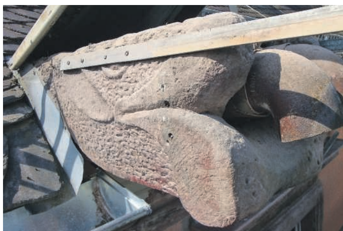
Der Wasserspeier war unter einer Blechverkleidung versteckt
