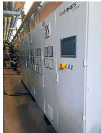
Blick auf den neuen Schaltschrank, rechts das „Touchpad“
