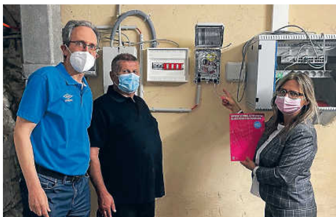
Telekom-Projektverantwortliche Ana Pia Engel (rechts), begleitet von Bürgermeister Dr. Ralf Göck und Telekom-Mitarbeiter Michael Zafirov (v. l. n. r.), zeigt den Glasfaserabschlusspunkt im „Alten Schulhaus“
