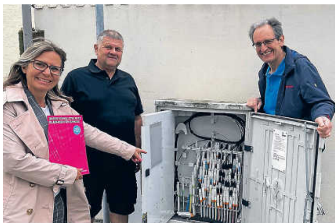
Bürgermeister Göck (re.) lässt sich die „Pipes“ in einem der 63 Glasfaserverteilerkästen, die in ganz Brühl und Rohrhof verteilt sind, von Telekom-Regionalmanagerin Anna Pia Engel und ihrem Mitarbeiter, Michael Zafirov, zeigen
